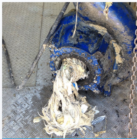
Feuchttuchabfälle verstopfen Pumpen und sorgen so für kosten- und zeitaufwendige Reparaturen
